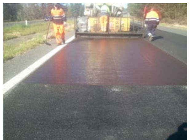
Fotografía 47.- Detalle de la junta transversal en la extensión de microaglomerado en frío.
